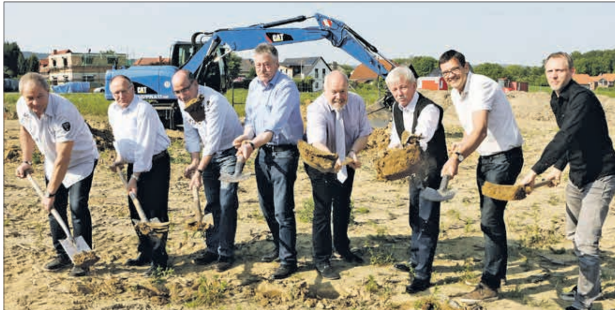
Gemeinsam machten Sie den ersten Spatenstich: Bauunternehmer Rüdiger Vogt, Vorstandsvorsitzender Horst Bohlmann, Christian Lemper, Wilfried Röhlings, beide Geschäftsleitung Lebenshilfe Lübbecke, Bürgermeister Rüdiger Meier, Helmut Exter, Vorsitzender des Aufsichtsrates der WuB und die Architekten Dirk Stanczus und Mario Schurbohm. Fotos (5): Lebenshilfe Lübbecke
